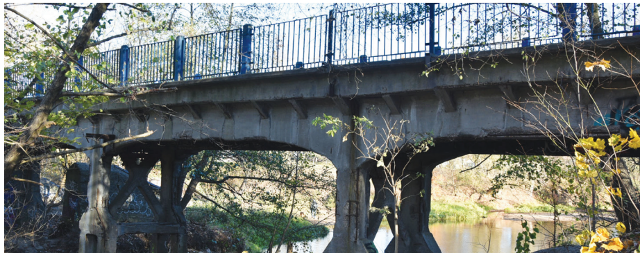
// Dawny most kolejki wąskotorowej zostanie wyremontowany.
